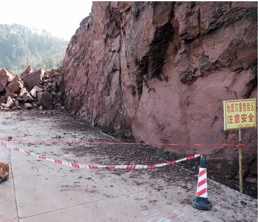
滑坡前当地封闭了公路。
