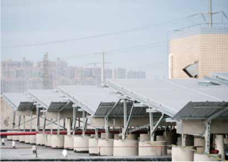
屋顶光伏电站结实耐用。
