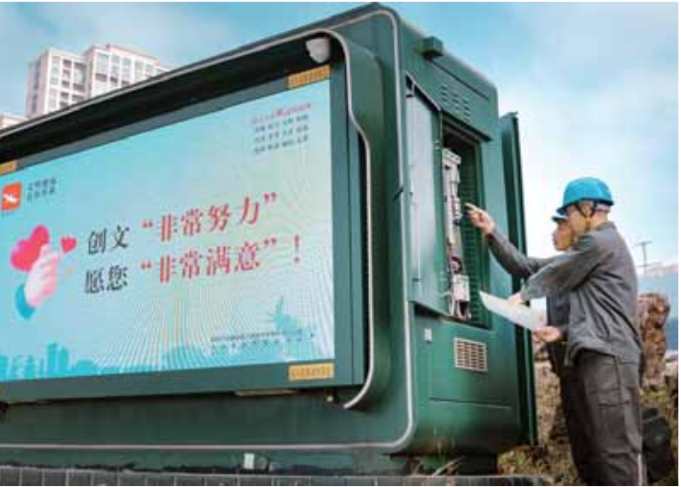
工作人员对网格内高可靠性全息感知环网箱开展日常维护。
