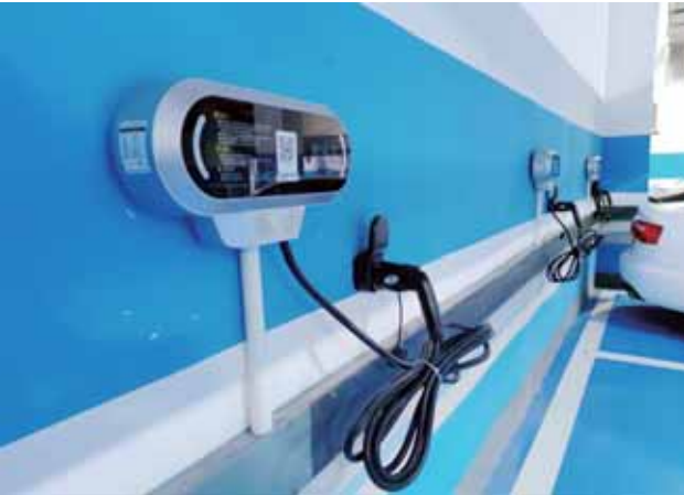
产业园区充电桩项目一角。
