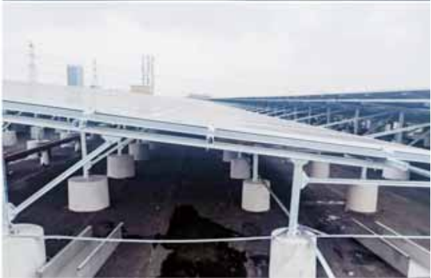
屋顶光伏项目一角。
