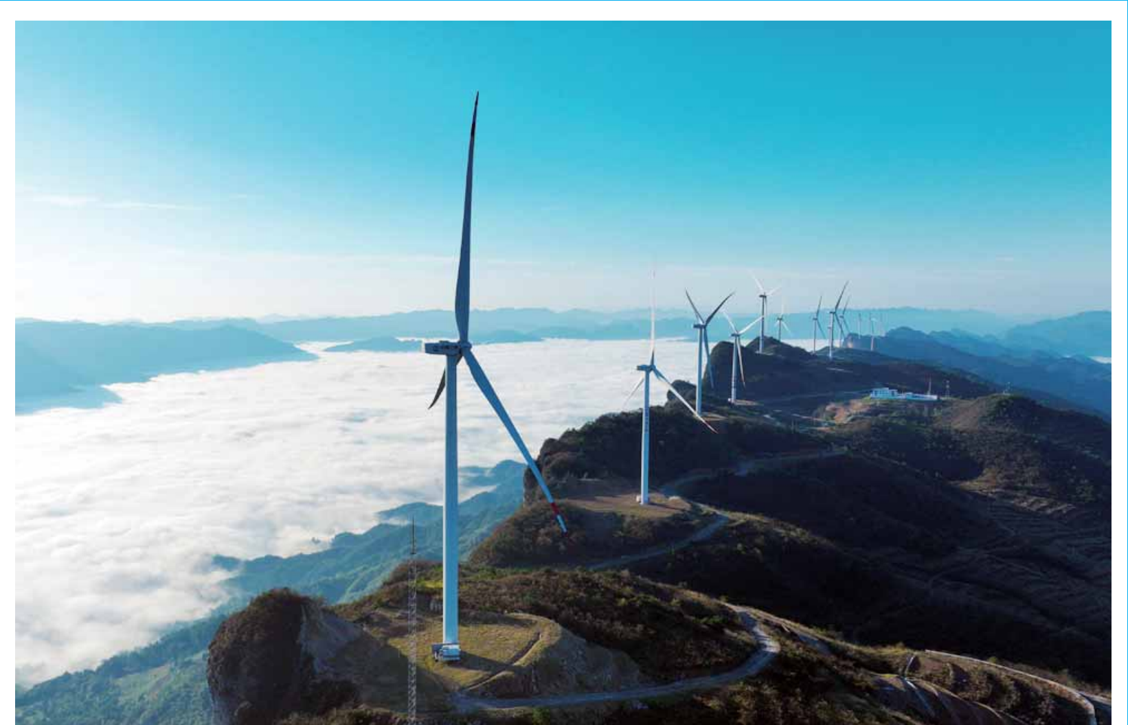
11 月 1 日拍摄重庆市黔江区五福岭风电场晨景（无人机照片）。近年来，重庆市黔江区走绿色低碳发展之路，发展清洁能源产业，在高山地区建起风电场、光伏发电站，为乡村振兴注入新能源。
