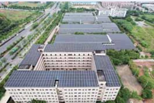
屋顶光伏发电在衡阳方兴未艾。 ■陈路华 摄
