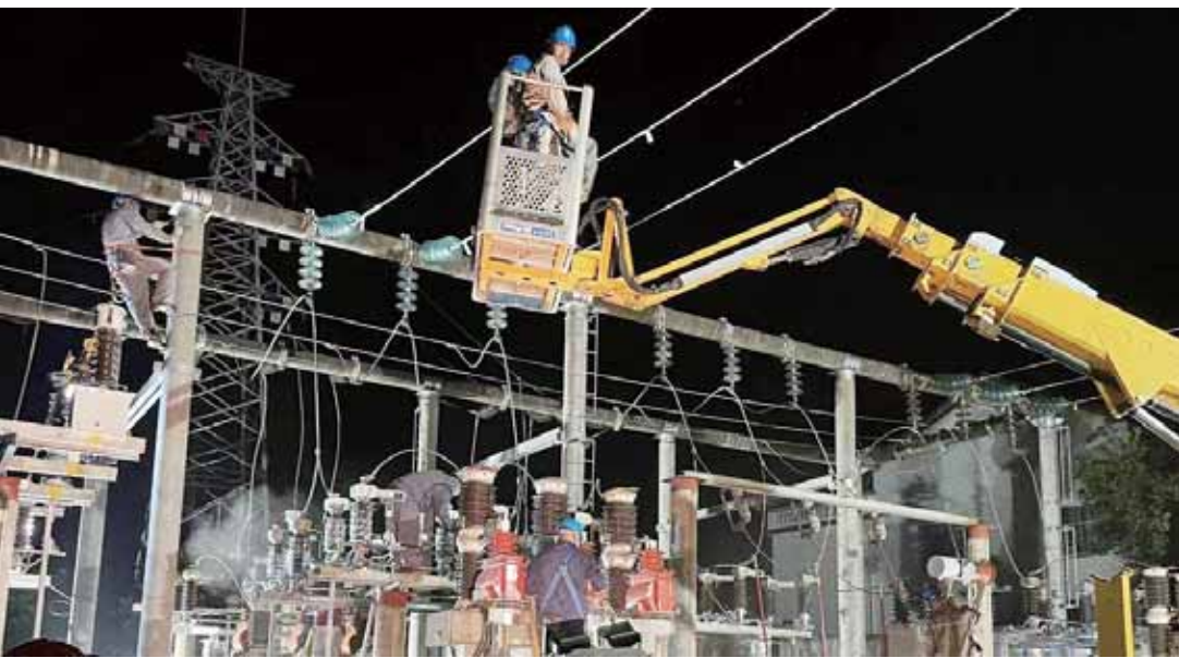
35千伏台源变电站主变升级改造现场。王尧尧 摄
