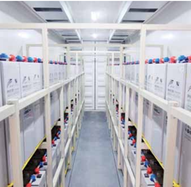
瑞达电源储能电站。
