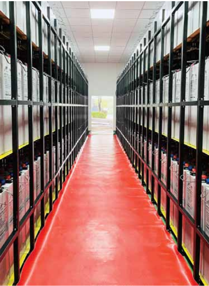
瑞达电源已建成的 2.16MWh 储能电站。
