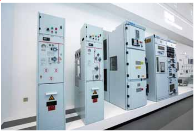
特变电工研制的中低压开关柜。
