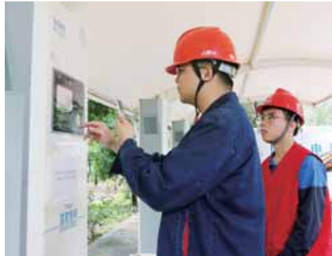
运维人员巡视检查公共充电桩。
