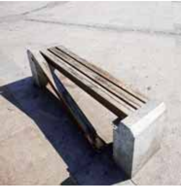
座凳方木脱落,锈蚀的铁钉裸露。
