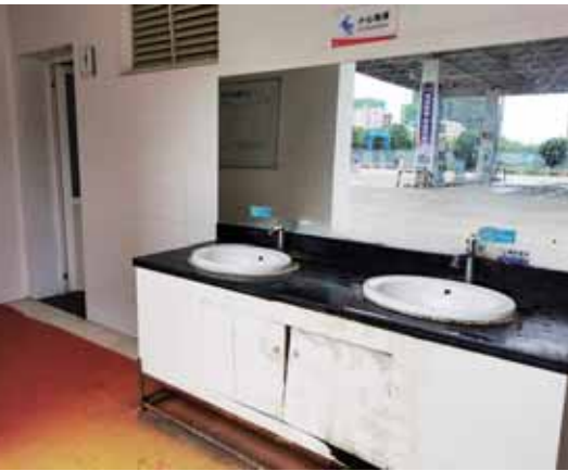
公厕洗手台破损严重
