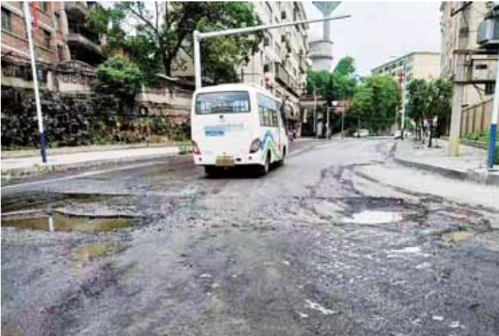
路面坑洞密布，破烂不堪
