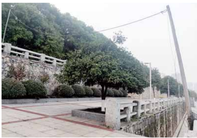
悬挂电缆的树杆(右)明显倾斜变形
