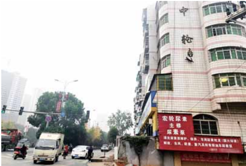
脱落的金属招牌字悬在距地面约 10 米的高空
