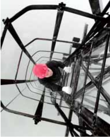
欧元生检修塔山基站
