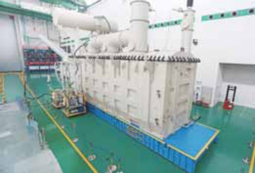
特变电工衡阳变压器有限公司自主研制变压器技术含量非常之高 ■王翟 摄
