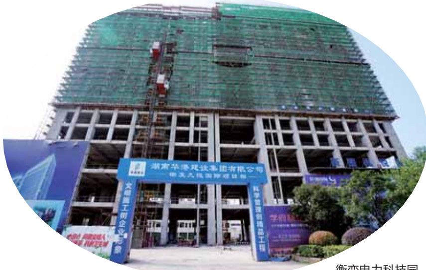
衡变电力科技园
