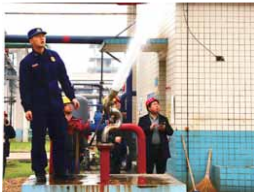
测试消防水炮 ■王凌峰 摄
