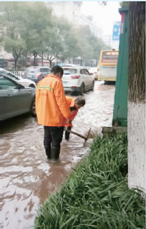
水管发生冻裂，导致路面积水，市政公司组织工作人员加紧抢修排空路面积水。
