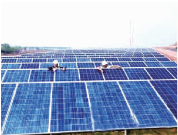
衡阳县太阳能屋顶
