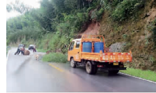
衡山县公路局快速处置塌方险情，确保公路安全畅通。
