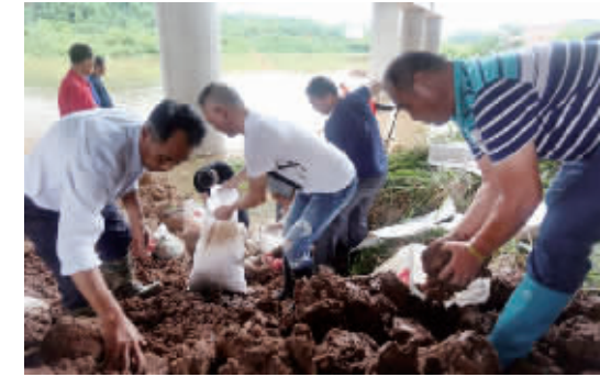
蒸湘区呆鹰岭镇杉旭河新民村黄美洲段涵闸拍门损坏，导致河水倒灌，区防汛部门组织人员进行抢险。
