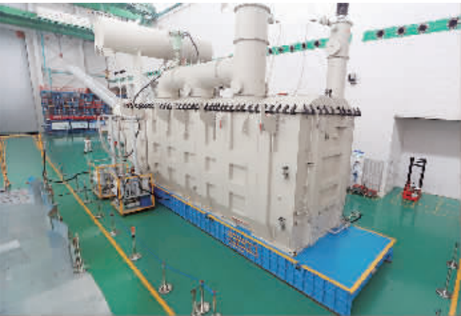
衡变公司自主研制的首台正负800kV直流换流变压器 ■王瞿 摄
