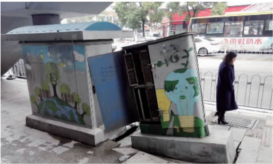
因为地面塌陷，通信箱已明显倾斜，紧靠配电箱，存在安全隐患。人行道板凹凸不平，过往行人纷纷绕道。
