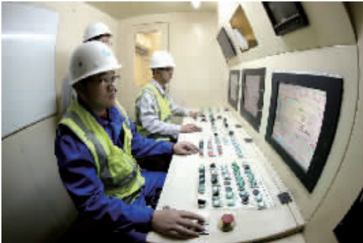
盾构机主控室。
