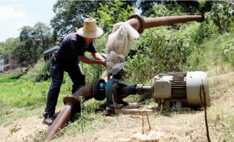
村干部在检修抽水泵。
