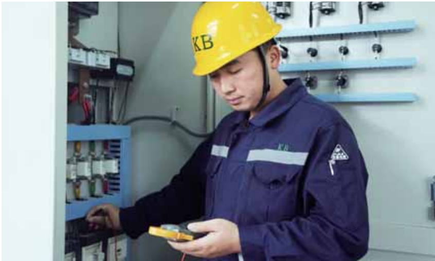
顾康乐正在检查电气设备。
