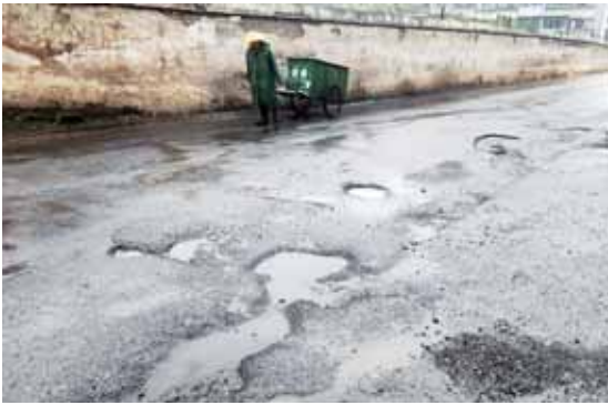
衡祁路上布满大小坑洞,亟待维修。
