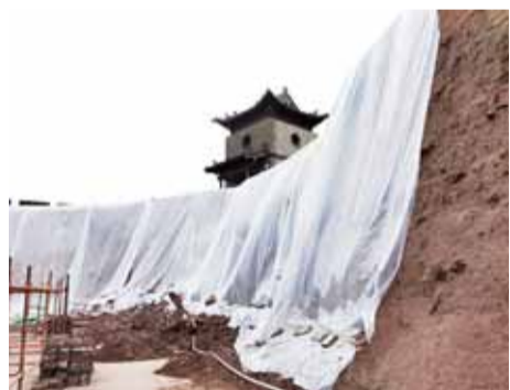
这是10月8日拍摄的平遥古城城墙坍塌处理情况。
