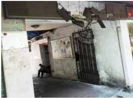
松脱脱落的显示屏模板位于进出通道口的门额上。
