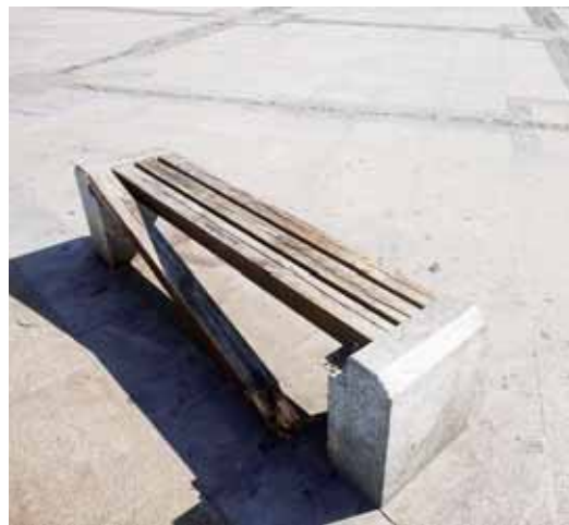
座凳方木脱落
