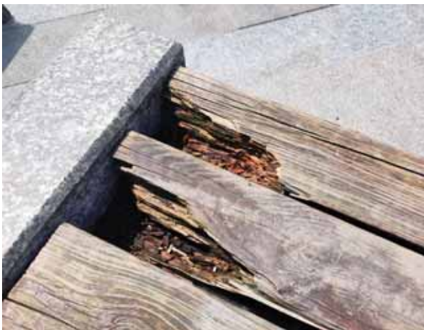
日晒雨淋,方木腐烂
