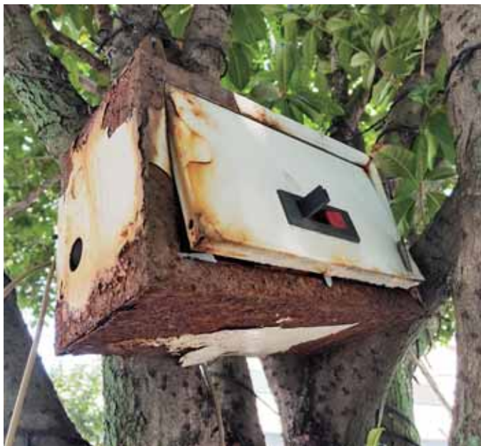
白色铁箱严重锈蚀，箱门开启。
