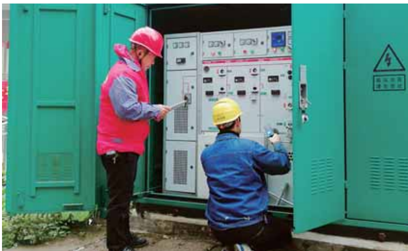
国网衡阳供电公司员工对城区配电设备开展超声波带电检测 ■周俊卫 摄
