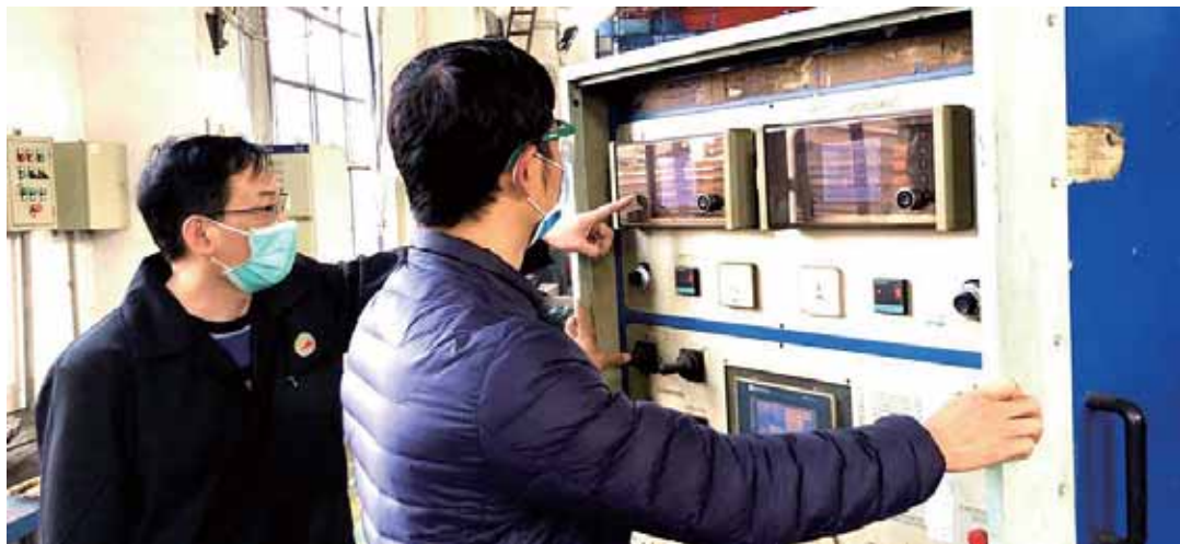
广铁工务大修段衡阳焊轨车间严格按照集团公司、段要求,车间党政工负责人各司其责,组织设备管理人员和设备操作手对车间内所有机器动力设备进行全面细查,确保元旦节后机械设备上线健康作业。图为车间有关负责人(左)在检查焊机设施时情景。
