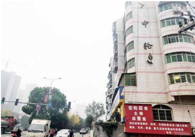
脱落的金属招牌字悬在距地面约 10 米的高空
