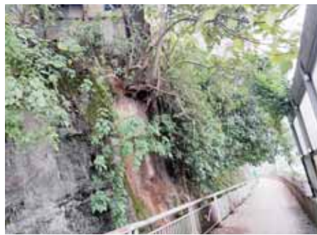
树根悬空裸露,存在安全隐患。
