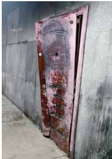
防盗门被人为撬砸,严重变形
