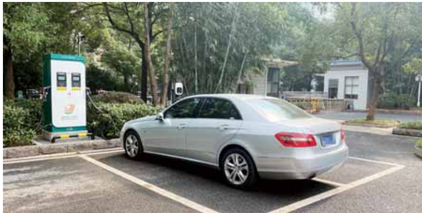
市政府东面新建的 120 千瓦直流快充充电桩已投入使用
