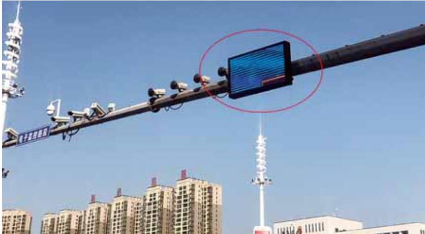
显示屏目前仍在调试中
