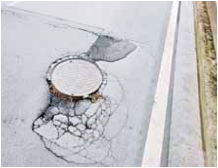
道路沥青层龟裂，破烂不堪。
