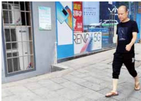
空调外机向过往路人直吹热气
