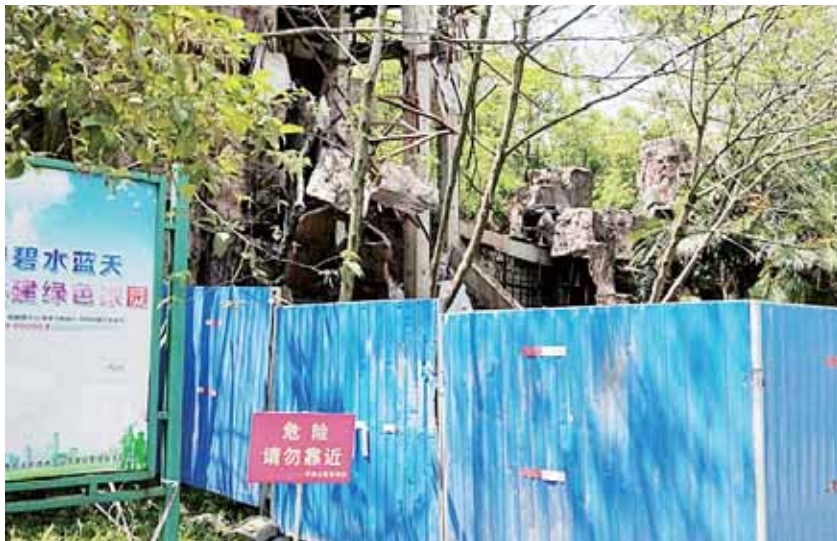
坍塌假山存在安全隐患
