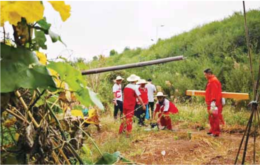
埋桩标记,防第三方开挖破坏
