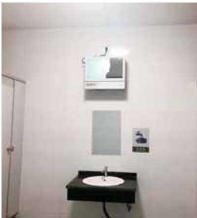
新安装的除臭设备
