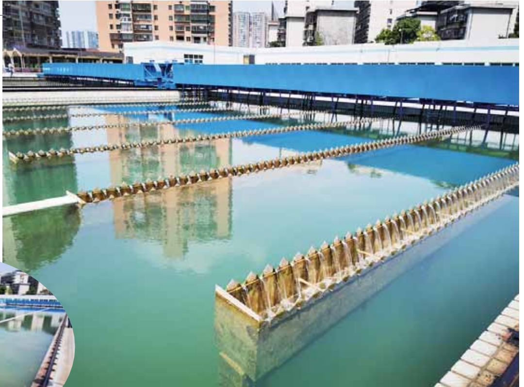
演武坪水厂平流沉淀池(尾端集水槽)
