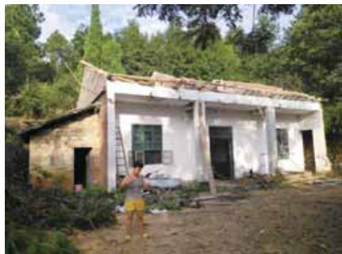
贫困户旷杰家危房改造前
