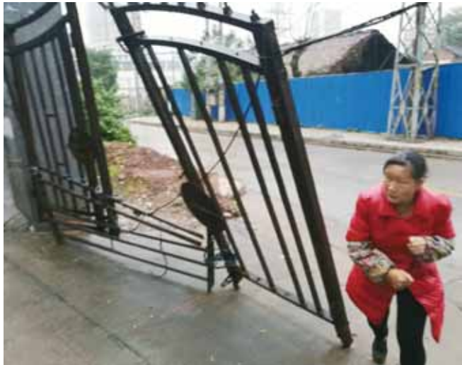
歪倒的铁门随时有可能倒塌
