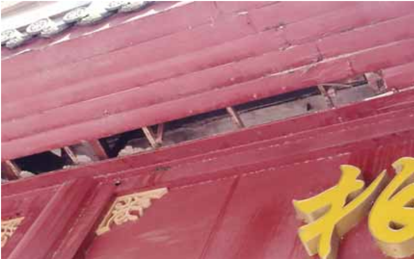
门头的条状木板脱落
