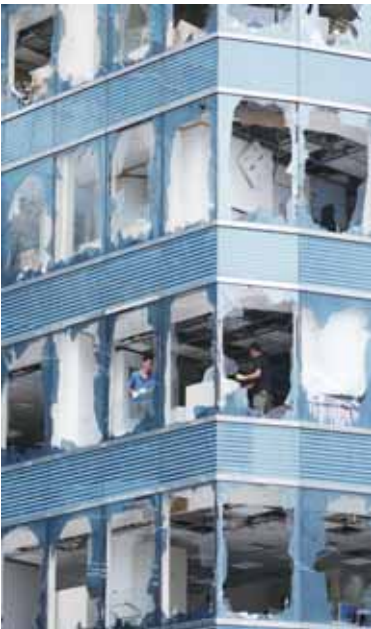
17日,在位于香港九龙半岛红磡海滨的一座写字楼中,工作人员在清理窗户破损的办公室。
